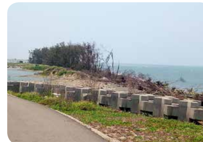
▲圖4-23 2016.10.22拍攝，七股西堤南端防風林已受嚴重侵蝕的狀況
