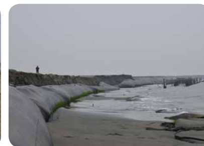
▲圖2-25 海水侵蝕呈陡崖狀，露出埋藏於沙洲兩側的沙腸與竹椿
