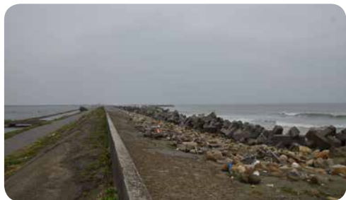
▲圖2-15 青山港汊南段海岸侵蝕嚴重，右側是侵蝕殆盡的青山港汊，左側是扇形鹽田扇端
